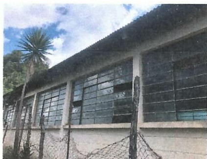
Foto 3: Se colocará balcones, en las ventanas debido que el salón no cuenta con ello, para mayor seguridad.
