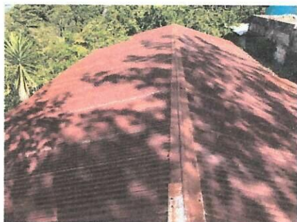
Foto 1: Se realizará cambio de lámina, en el salón de usos múltiples por deterioro y agujero de las mismas, ya que se utiliza como salón de clases de segundo Básico de Telesecundaria .
